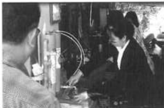
(จ) จุดที่ ๕ ติดตั้งเครื่องกรองสนิมเหล็กในน้ำ
